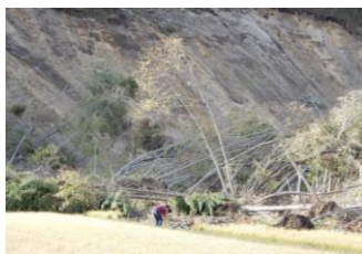
山崩れの現場を視察しました
