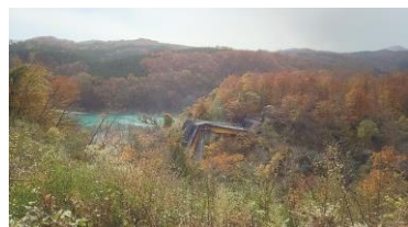
倒壊した祭時大橋
